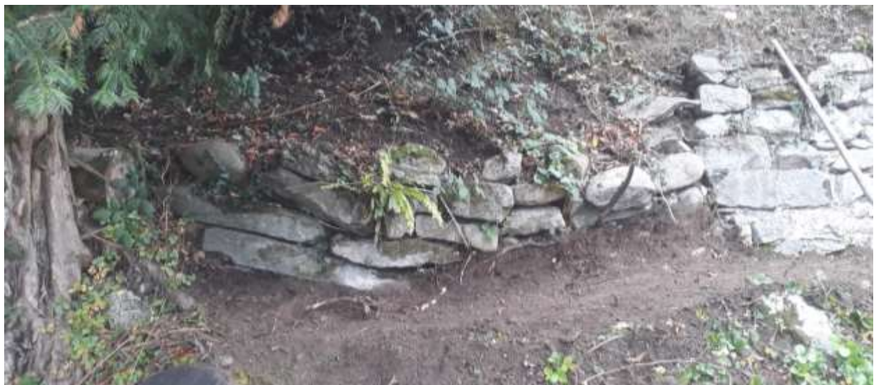
Abzubrechendes Mauerstück, soll neu aufgemauert und optisch angeglichen werden.
