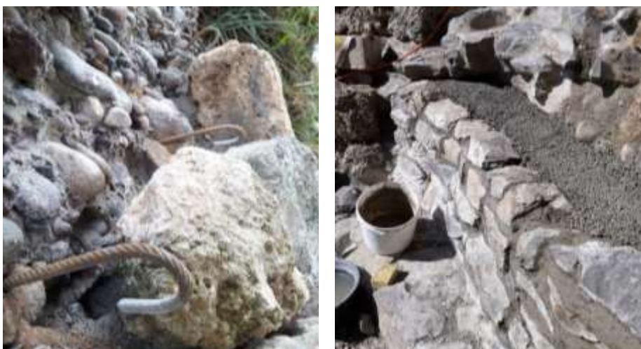
Ankereisen in der Nagelfluh (hier beim Tuff), aufgefüllte Zwischenräume
