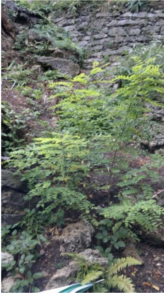
Wildwuchs in der Grottenanlage (Robinien, Efeu usw.)
