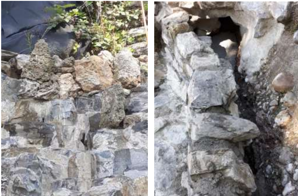
Kalksteinmauer mit Auflagern, Mauer liegt nicht direkt auf der Nagelfluh.
