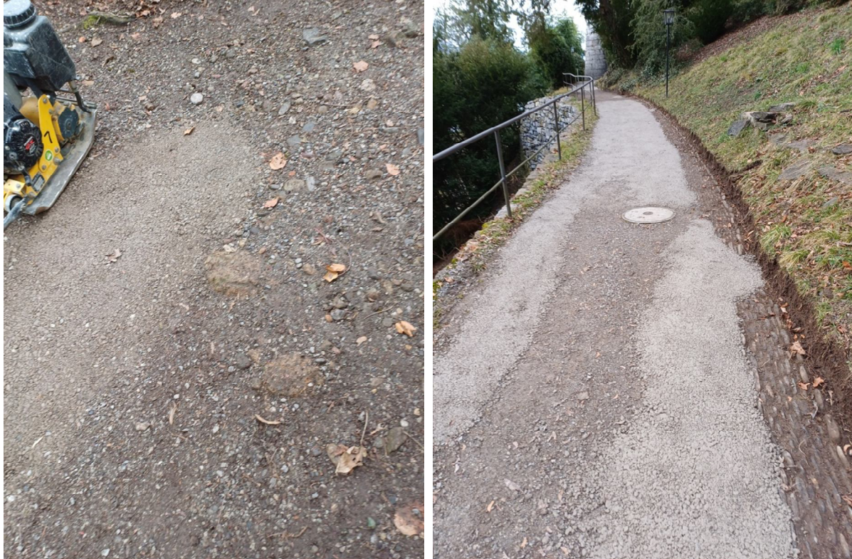
Überdeckte Wasserschale (l), mit Mergel gesicherte Ränder und Fehlstellen (r).
