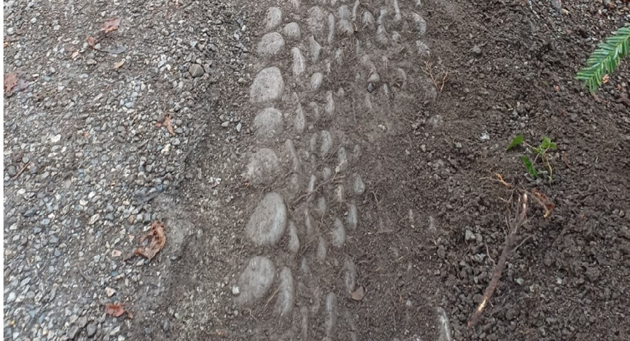
Stark geneigte und abgerutschte Steine im mittleren Bereich.
